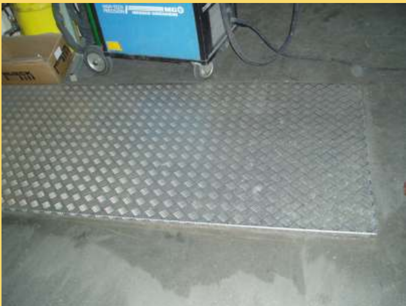
Energiematten mit Riffelblech für Arbeitsplatz Heizung
